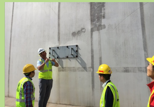
倉庫やドーム倉庫のランス挿入口
