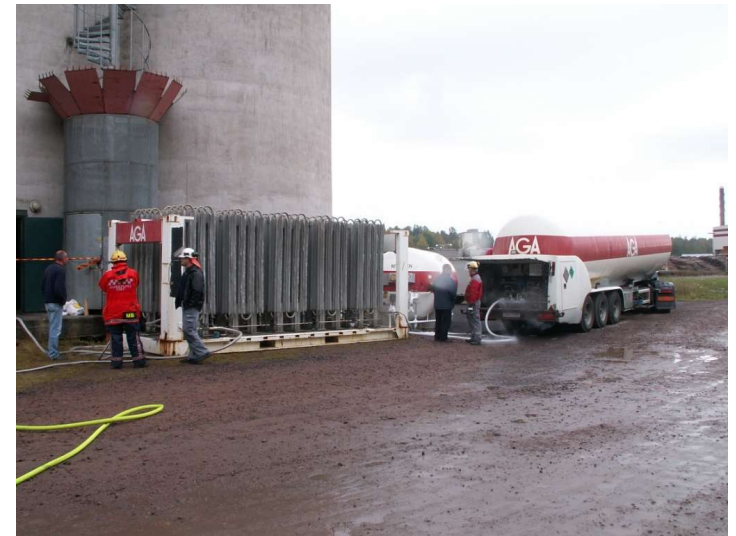
移動式エバボレータの写真。ガスタンクとタンカー車 [Persson, Henry. 2013. Silo Fires - Fire Extinguishing and Preventive and Preparatory Measures]
